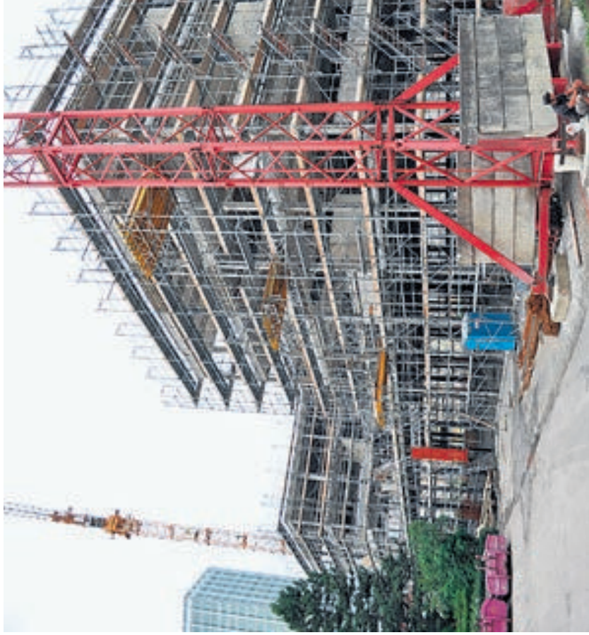
Das Anton-Graff-Haus wird zurzeit saniert, im März 2012 soll es fertig sein. Bild: am
